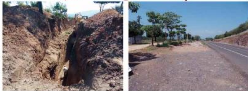
Colector de drenaje salida a El Limón
