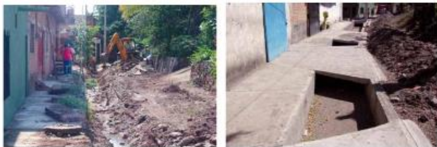
Colector de aguas pluviales en Circunvalación
